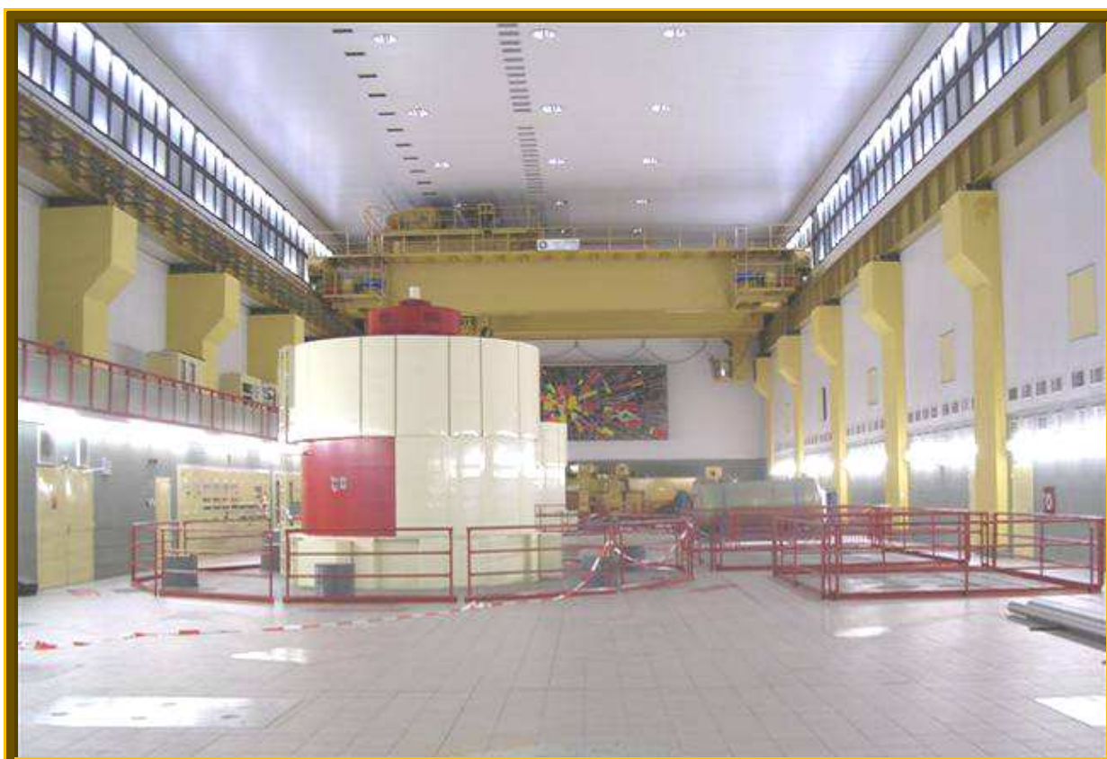
Kaverna se dvěma soustrojími – pohled na rozběhové motory
